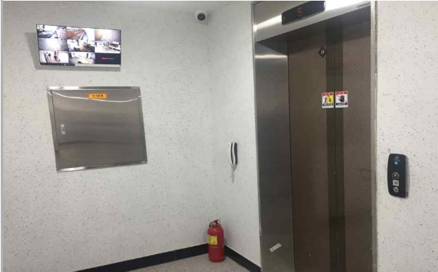
승강기 및 보안용 CCTV
